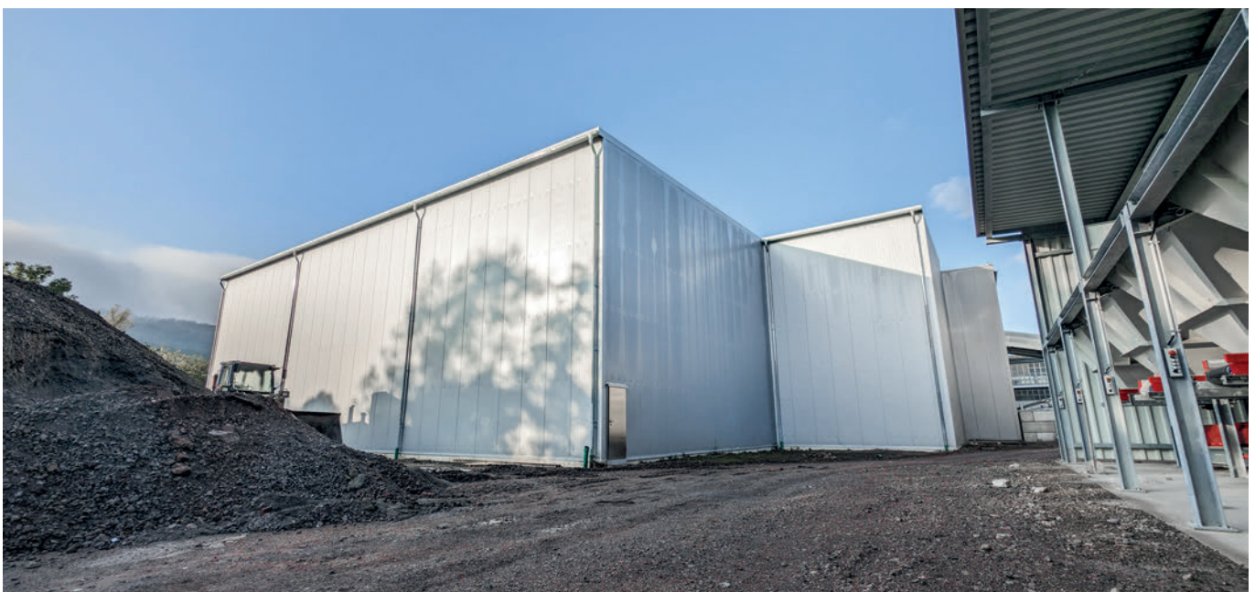
Moderna cámara de curado de Kraft Curing Systems GmbH en Alemania
