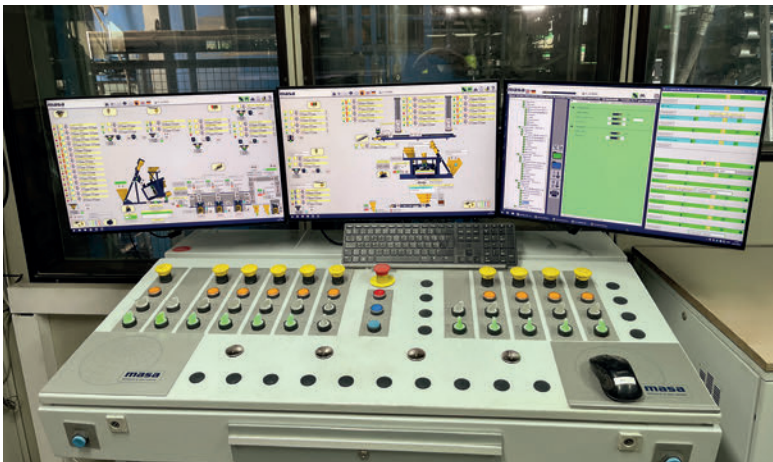
Steuerstand bei Rünz & Hoffend vor und nach der Modernisierung
