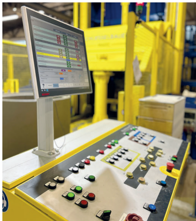
Comodo funzionamento dal quadro di comando
