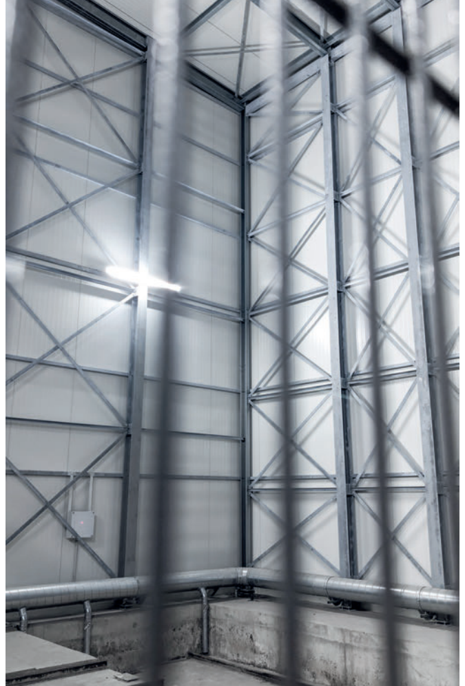
Un système de distribution d'air chaud a également été installé dans la zone du chariot transbordeur.
