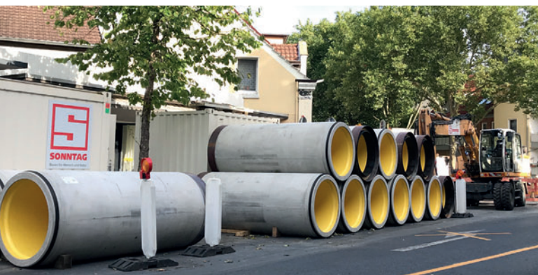
Проект Datteln, Северный Рейн-Вестфалия, Германия: открытый склад труб для микротоннелирования Perfect Pipe DN1200 компании Beton Müller
