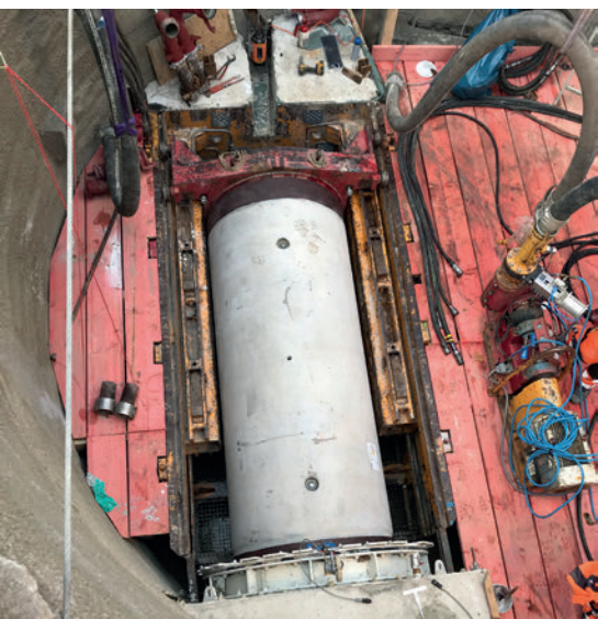
Chantier de Dattel : le tuyau suivant est en cours de fonçage, l'emboîtement se fera au moyen d'un connecteur pré-monté.
