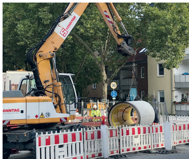
Chantier de Datteln : mise en place dans la fosse de départ, tuyau avec lubrification à la bentonite.
