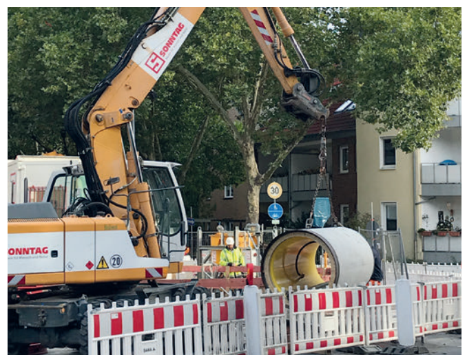
Proyecto de Datteln: elevación en zanja inicial, detalle de lubricación de bentonita de las tuberías.
