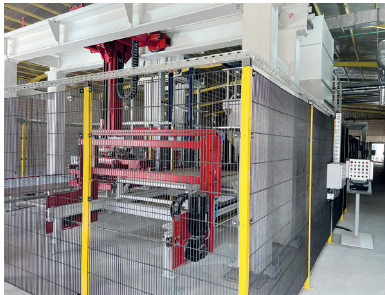
Безопасная зона подающего конвейера станции кубирования
