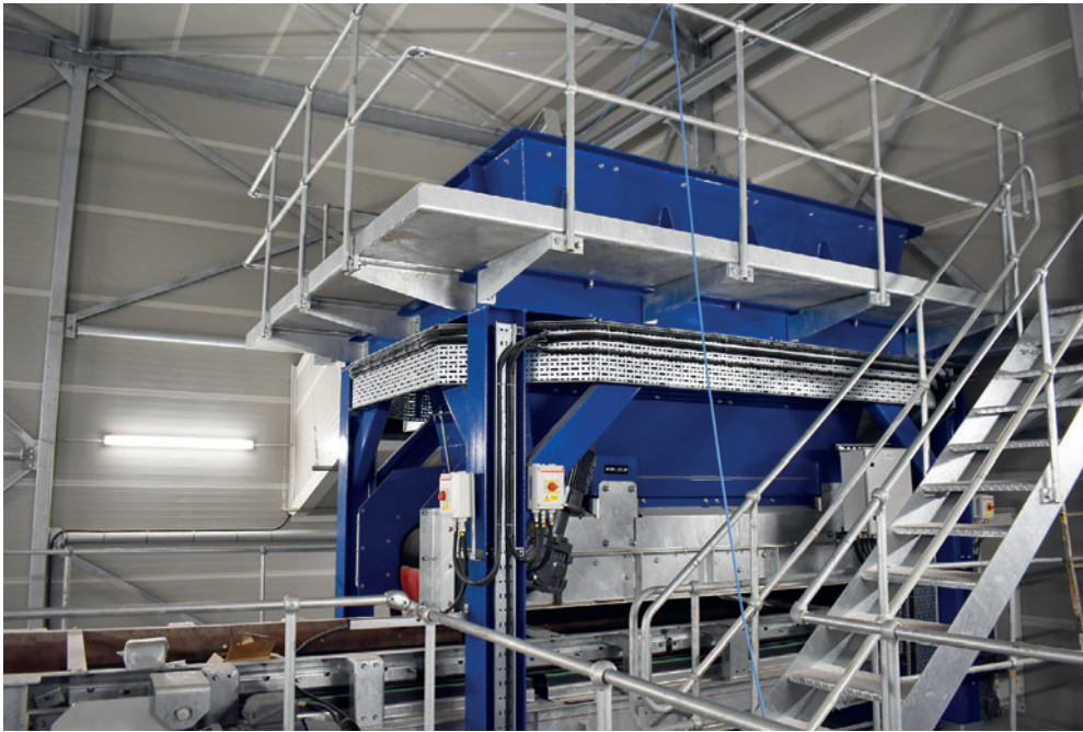
Вибропресс Columbia 1600 расположена в звукоизоляционном машинном отделении
