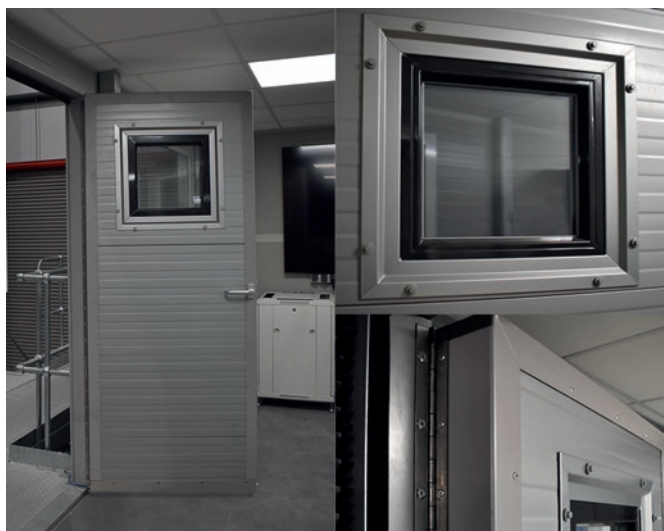
Dokładny widok drzwi dla personelu wykonanych z materiału dźwiękochłonnego.
