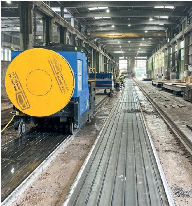
Płyty kanałowe są produkowane na torach o szerokości 1,2 m i długości ok. 150 m.
