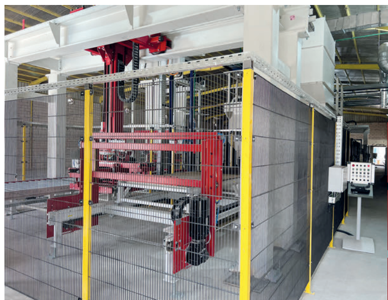
Zona de seguridad en la entrega del apilador de planchas
