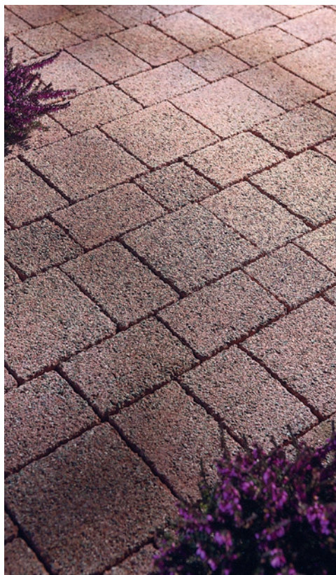
Kostka brukowa poddana młotkowaniu – widoczne są wyszczerbione krawędzie.
