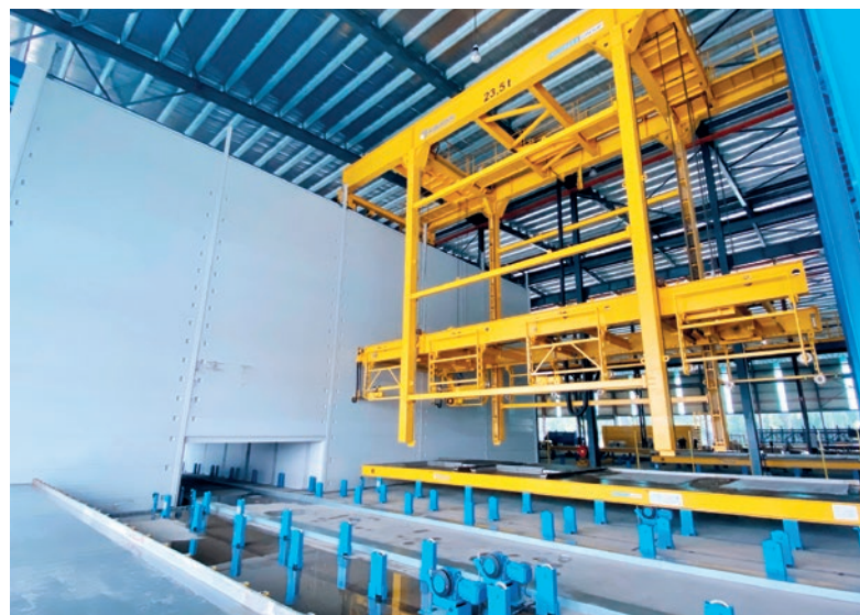
Wydajny i zautomatyzowany system magazynowania zapewnia szybkie i płynne działanie zakładu.
