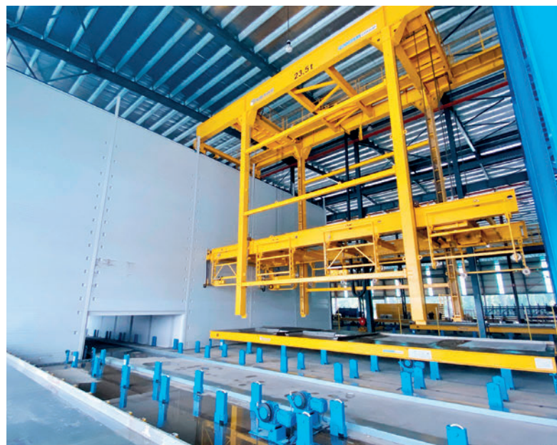
Un sistema di stoccaggio efficiente e automatizzato garantisce un funzionamento rapido e perfetto dello stabilimento.
