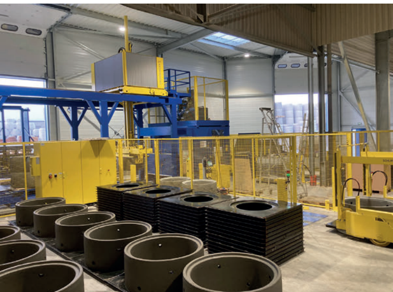
Vista sull'impianto di pallettizzazione nell'edificio annesso.
