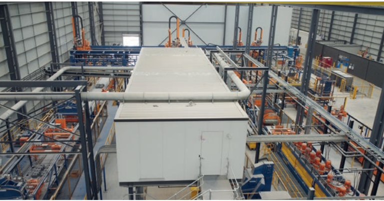
Linia uszlachetniania z platformą na szafki sterownicze, widok z góry.
