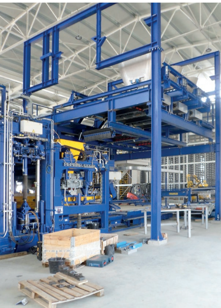
Montaż serca linii technologicznej, wibroprasy Masa XL-R z systemem Multi-Color (tutaj dla betonu licowego) wymagał doświadczenia i precyzji.
