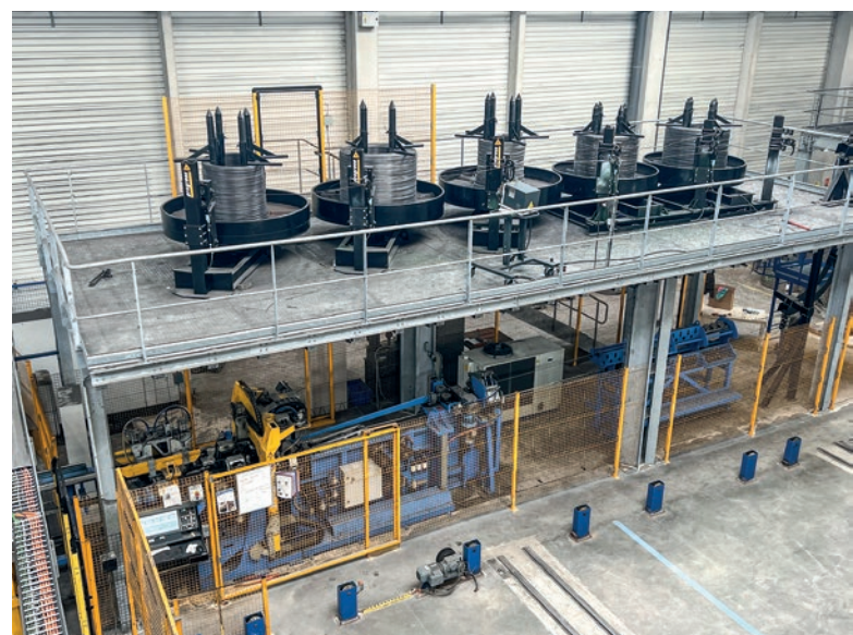
Zgrzewarka do kratownic Versa została zamontowana pod kręgami, aby zaoszczędzić miejsce. Produkuje kratownice zgodnie z bieżącym zapotrzebowaniem.
