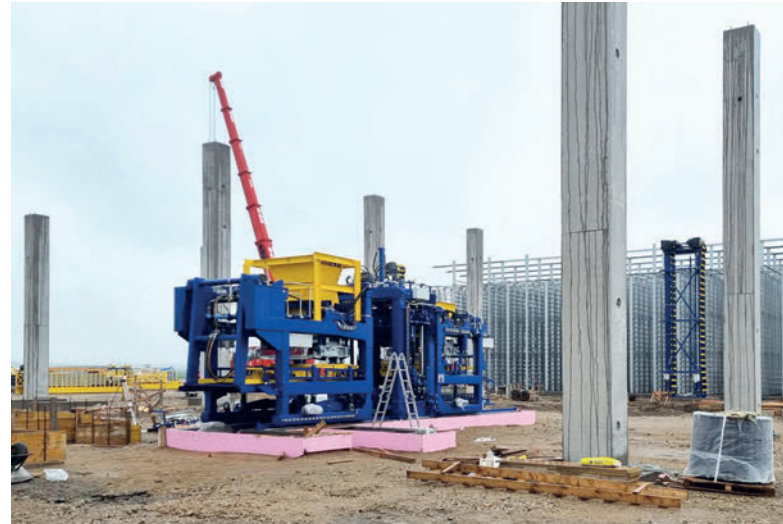
Fase di costruzione iniziale: progressivamente si installa il nuovo impianto high-tech attorno a XL-R Masa.
