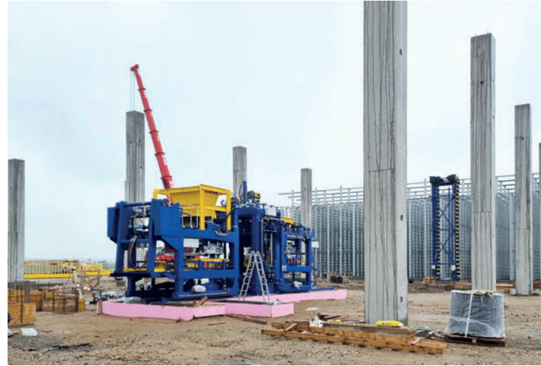
Première phase de construction : petit à petit, la nouvelle installation high-tech est mise en place autour de la machine XL-R de Masa.
