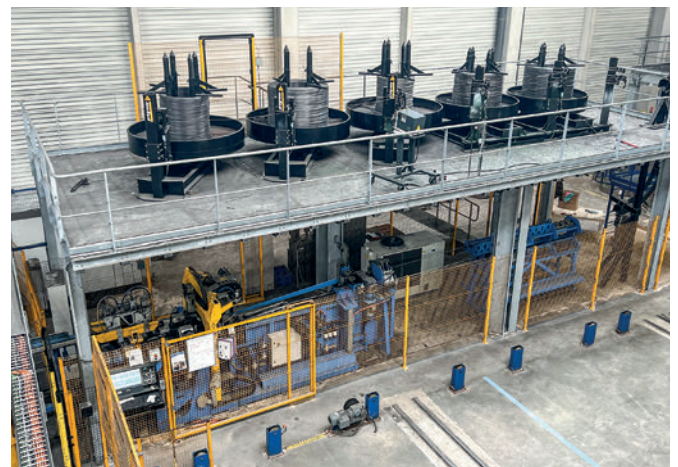
La soudeuse de raidisseurs Versa a été installée sous les bobines afin de gagner de la place et permet une production « just-in-time » des raidisseurs.
