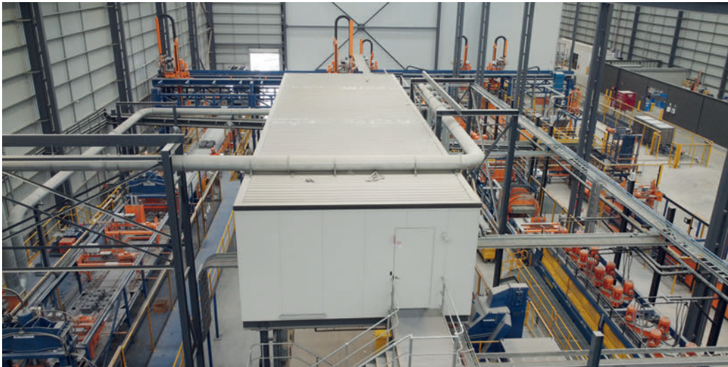
Draufsicht auf die Veredelungslinie mit Podest für die Schaltschränke
