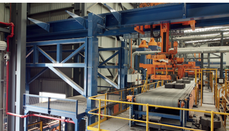
251 号位点处的压块机俯视图，此处连通了用于分割加工线进料的皮带输送机
