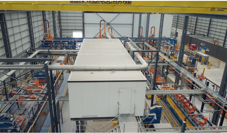
配备了开关板基座的增值生产线俯视图
