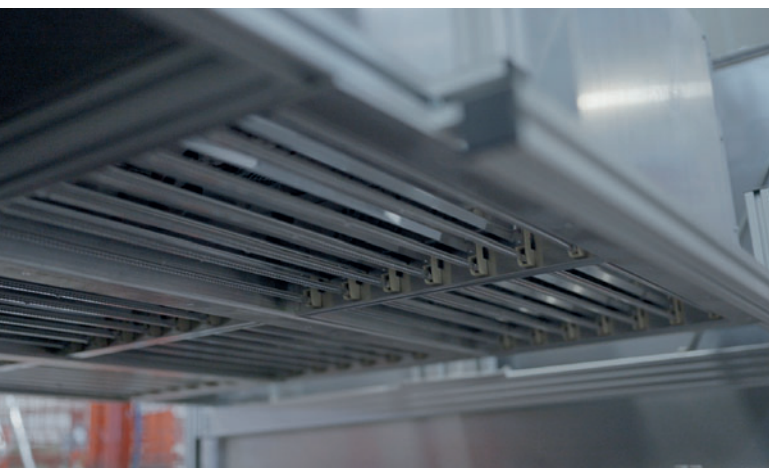
Нагревательный модуль линии для нанесения покрытия
