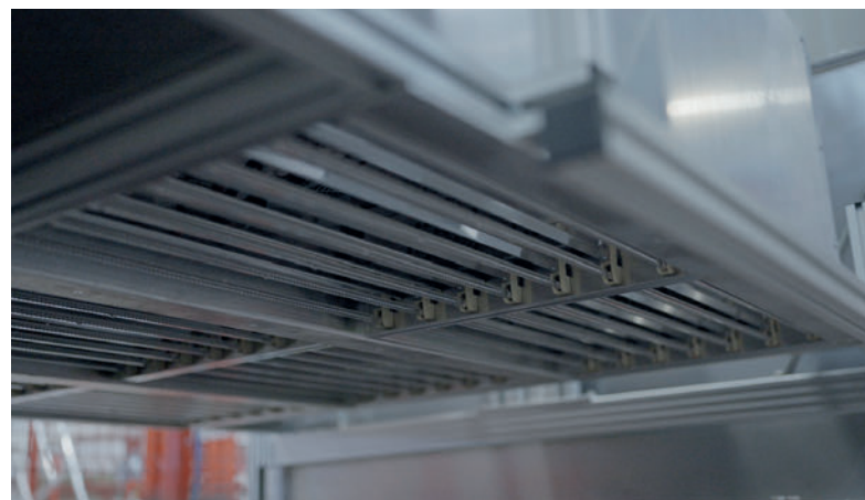
Modulo di riscaldamento della linea di rivestimento
