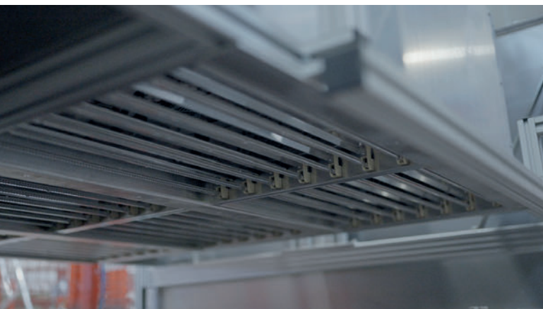
Módulo de calentamiento de la línea de recubrimiento
