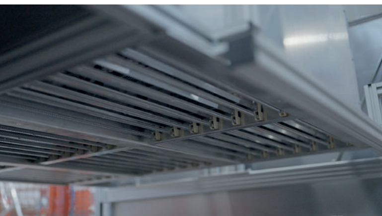
Heizmodul der Beschichtungslinie
