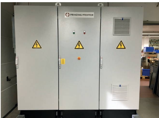
Kompletny elektryczny system sterowania jest zamontowany w trzydrzwiowej szafie sterowniczej (wysokiej jakości, sprawdzona na całym świecie technologia Siemens Simatic S7).
