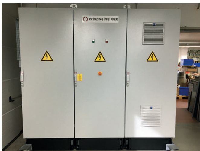
L'intero sistema di controllo elettrico è collocato nel quadro elettrico ad armadio a tre ante (tecnologia Siemens Simatic S7 d'alta qualità e collaudata in tutto il mondo)
