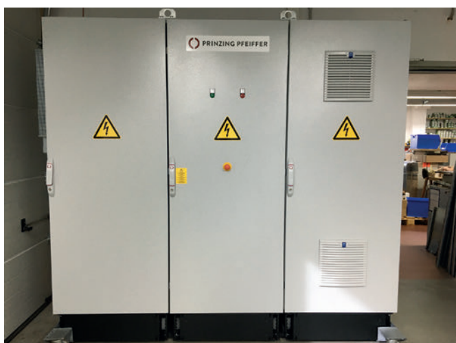
Commande électrique complète installée dans l'armoire de distribution à trois portes (technologie Siemens Simatic S7 de haut de gamme renommée dans le monde entier)
