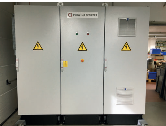
El control eléctrico completo está montado en el armario de distribución de tres puertas (tecnología Siemens Simatic S7 de alta calidad y eficacia probada a nivel mundial)
