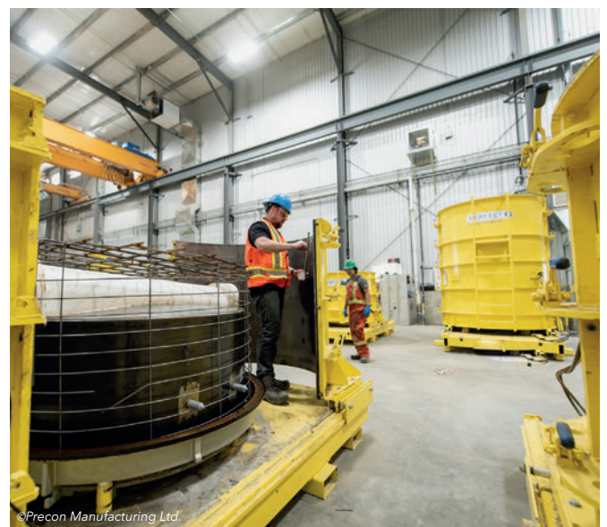
Colocación del canal, los peldaños y el refuerzo en la pared y el suelo.
