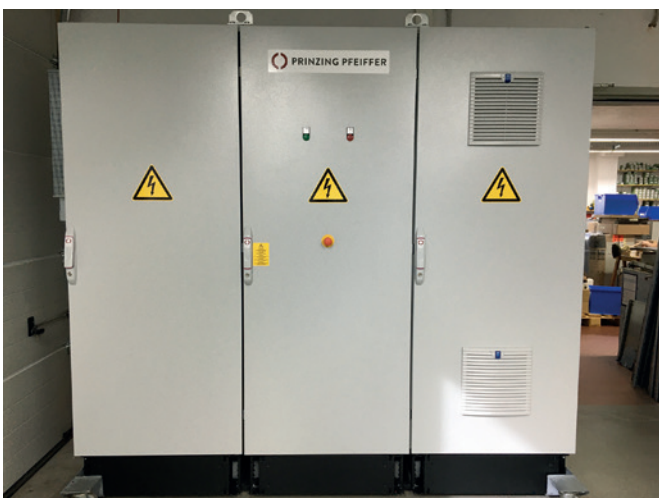
Die komplette elektrische Steuerung ist im dreitürigen Schaltschrank eingebaut (hochwertige und weltweit bewährte Siemens Simatic S7-Technologie)
