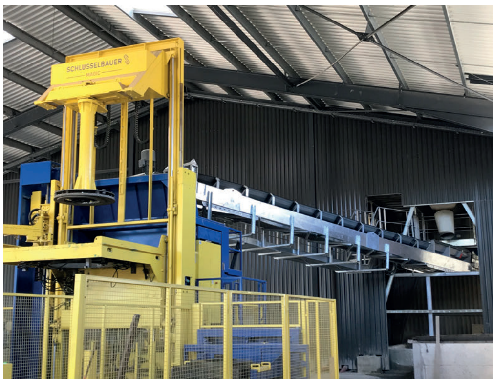
Vista dell'impianto Magic 2, entrato in servizio quest'anno presso CRP.
