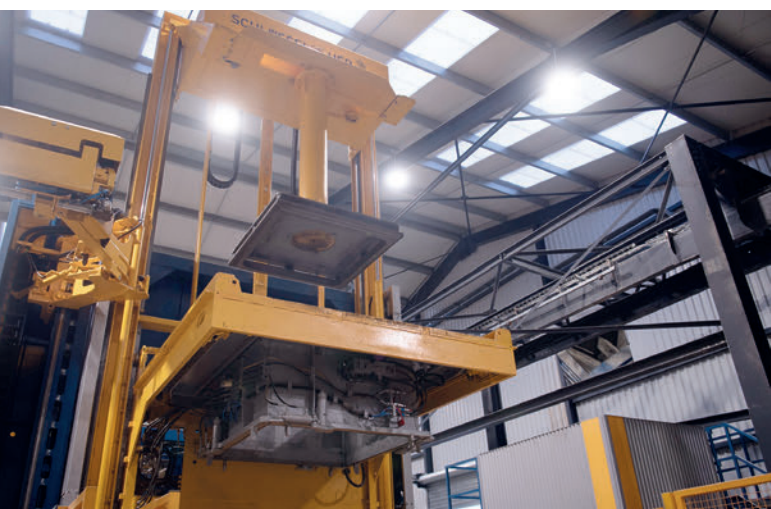
Installation de production Magic 1 de Schlüsselbauer Technology chez CRP
