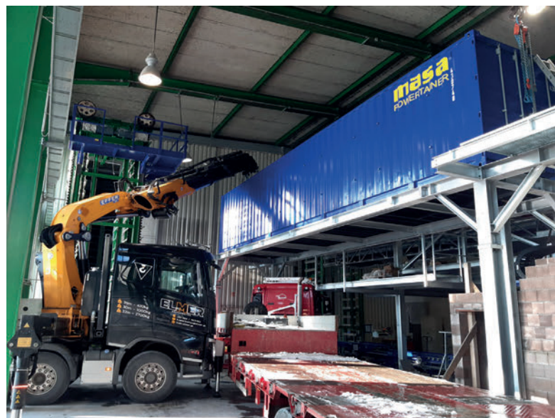
Précâblé sur le chantier : le Powertainer de Masa
