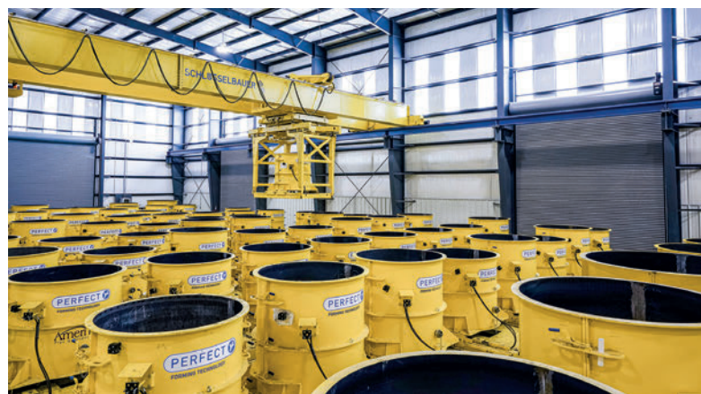
Transexact - Automatisierter Kranbetrieb und Formenverwaltungssystem in einem
