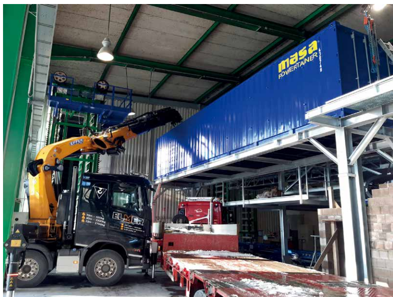
在施工现场完成预接线：Masa 公司出产的 Powertainer
