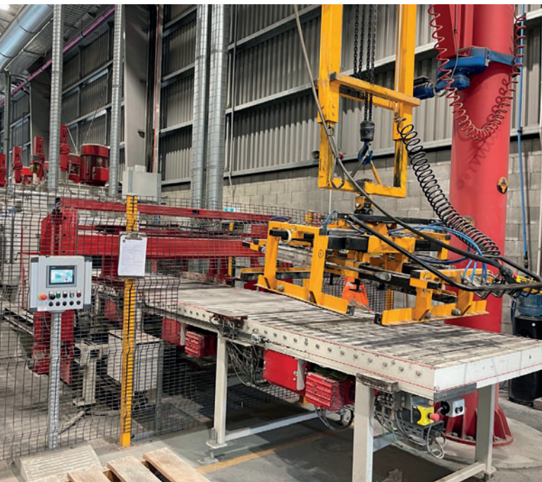
Подача с помощью поворотного крана и 4-стороннего клещевого захвата; роликовый конвейер, интегрированный в систему безопасности
