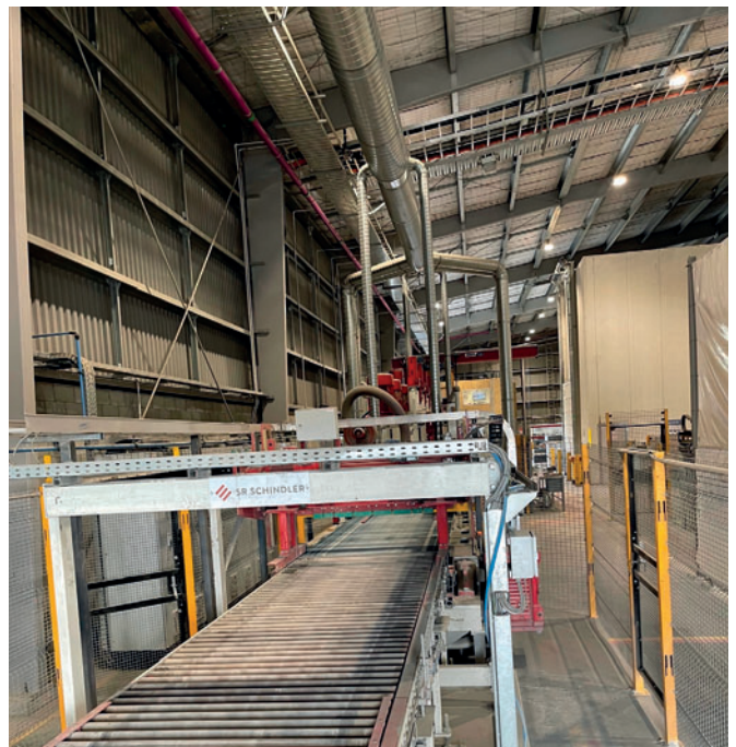
Трубная обвязка системы пылеудаления
