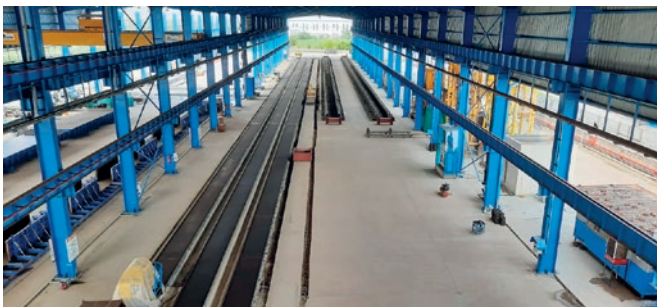
W nowym zakładzie firmy Stellar Precast płyty kanałowe są produkowane na czterech torach o długości 145 m.
