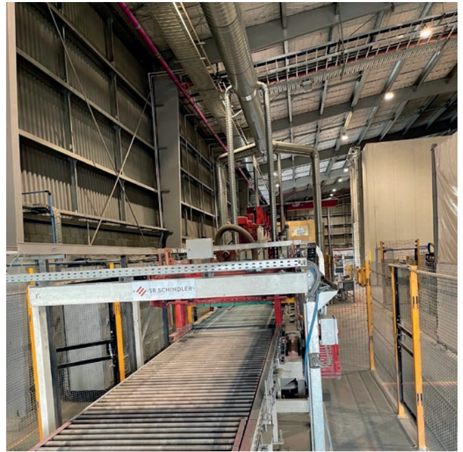
Przewody systemu odpylania.
