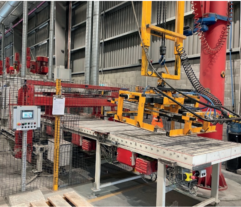
Podawanie wyrobów za pomocą obrotowego chwytaka czterostronnego i przenośnika rolkowego zintegrowanego z obszarem bezpieczeństwa.
