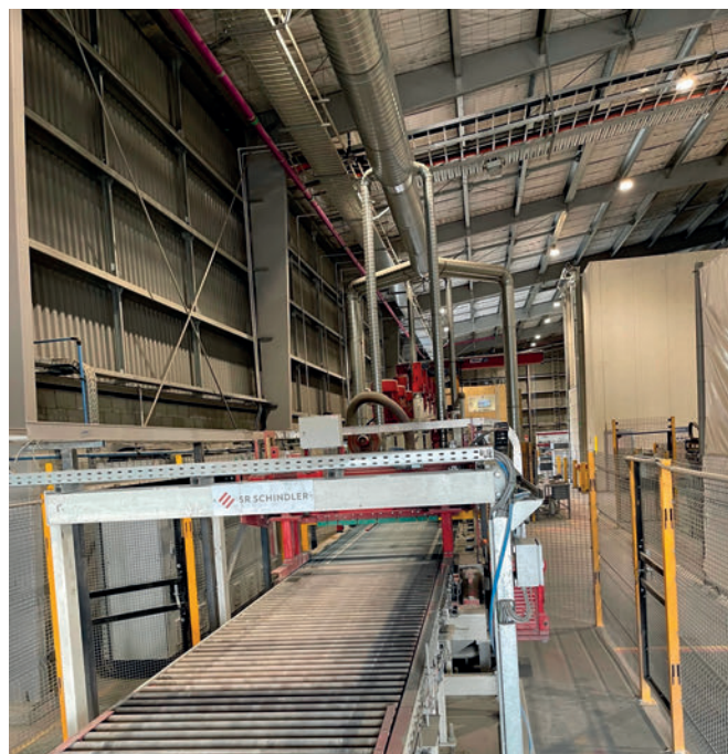
Tubazione dell'impianto di depolverazione
