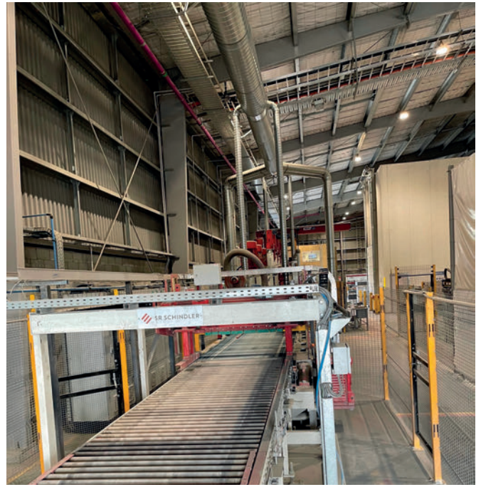
Tuyauterie de l'installation de dépoussiérage
