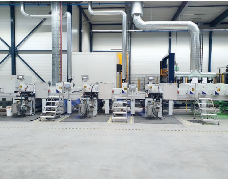
Drugi odcinek linii powlekania i suszenia.
