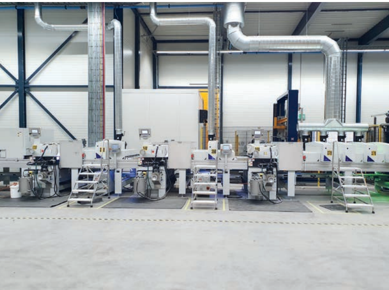
Ligne de revêtement et de séchage II
