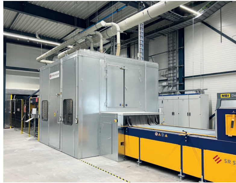
Schallschutzkammer für die Alterungsanlage
