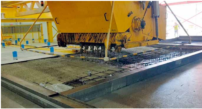
计划实现混凝土按需供应的自动化
