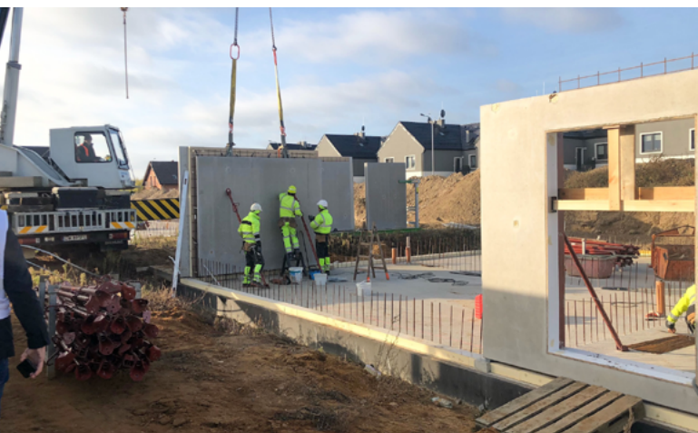
Le montage rapide sur le chantier est assuré par une équipe bien formée et professionnelle, qui maîtrise le maniement des différents éléments préfabriqués en béton.
