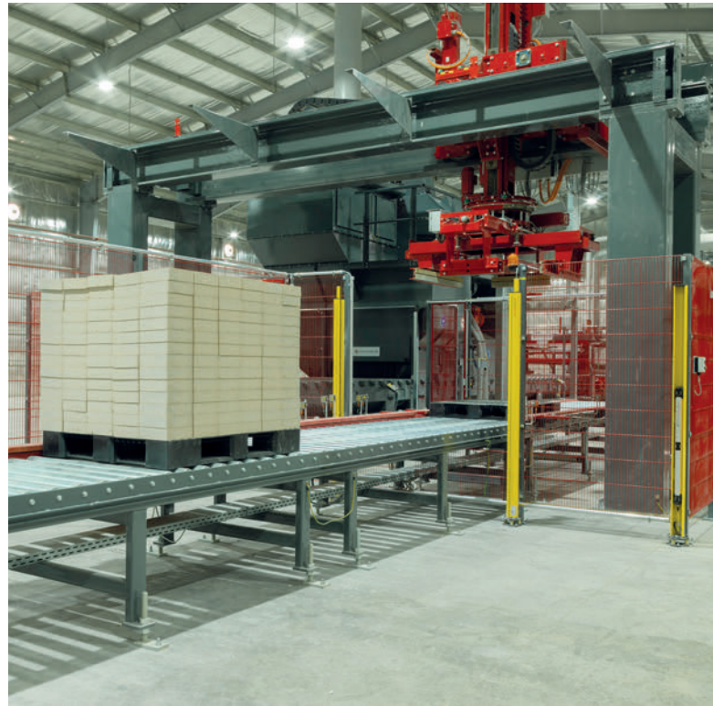
Los paquetes de bloques a tratar son transportados con el transportador de carga pesada al apilador de capas LPU.
